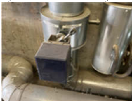
Hydraulische Umschaltung Pellet-/Ölbetrieb
