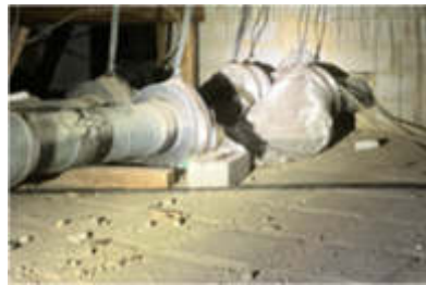
Schubventilatoren außer Betrieb
